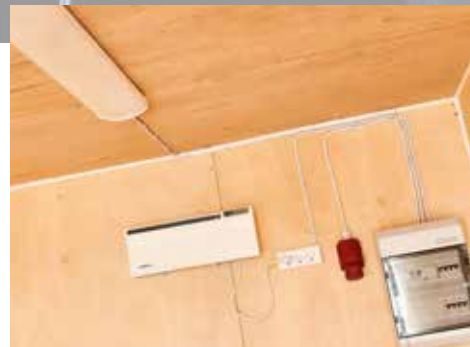
Isoleret container med lys, varme og el.
